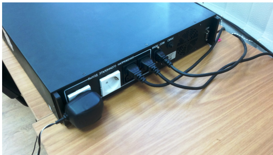
Рис.16. Источник эталонного электропитания.
