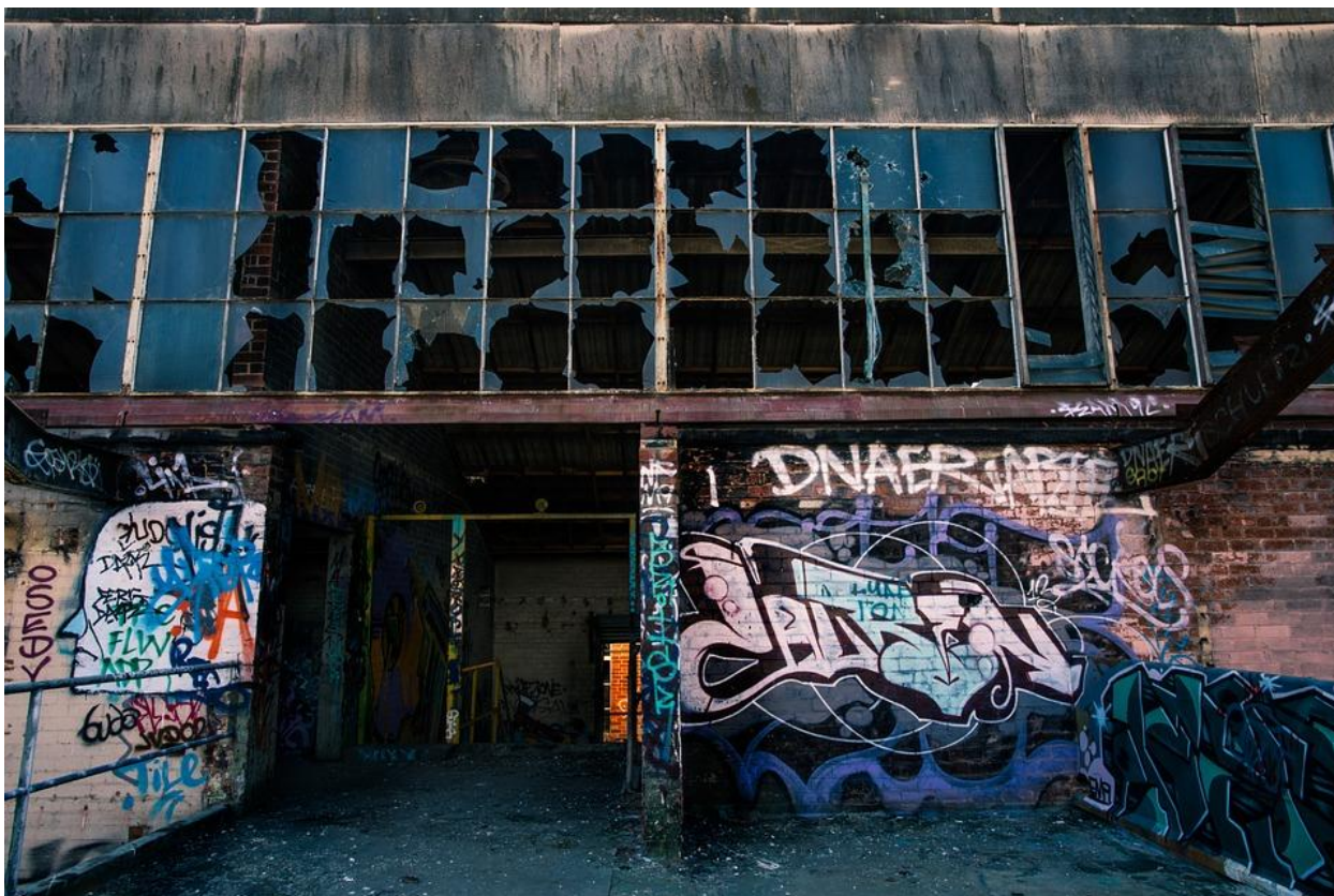
Рис.б. Символы внешнего разрушения
