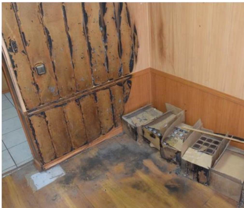
Рисунок 1. Термические повреждения напольного покрытия при горении разлитой ЛВЖ
