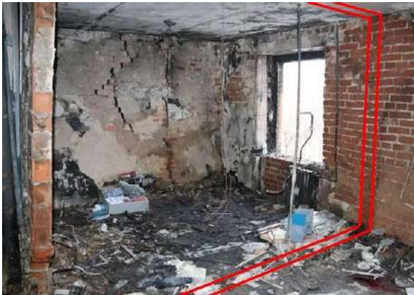
Рис. 1. Кухня квартиры № 1 (красными линиями обозначена граница стены, разрушенной взрывом)
