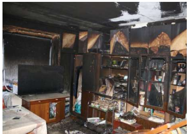
Рис. 6. Повреждения дальней комнаты квартиры № 2
