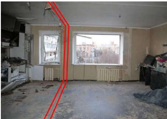
Рис. 3. Разрушения в квартире № 3 после разбора завалов
