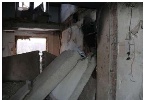
Рис. 4. Обрушение межэтажных перекрытий в квартирах № 1 и № 3
