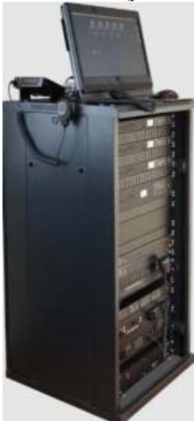
Рис. 1.71. Стойка с системой беспроводной связи «Радиокупол»
