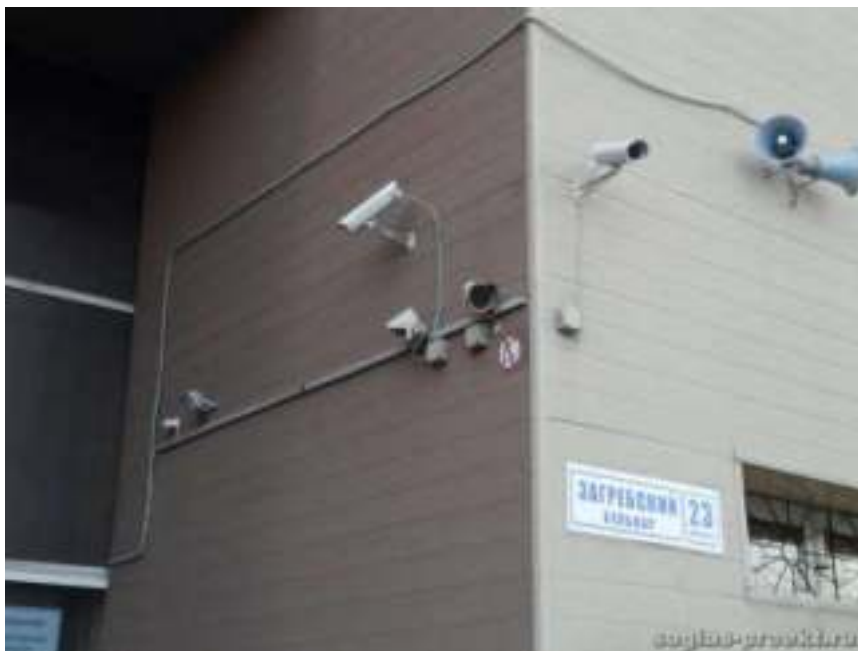
Рис. 2.72. Вариант применения видеокамеры, входящей в состав телевизионной системы охраны объекта
