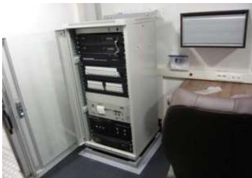
Рис. 1.59. Комплекс аппаратуры ретрансляции и телекоммуникации блочно-модульного исполнения
