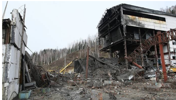
Рис. 3. Последствия взрыва на шахте «Распадская», Кемеровская область, 2010 г.
