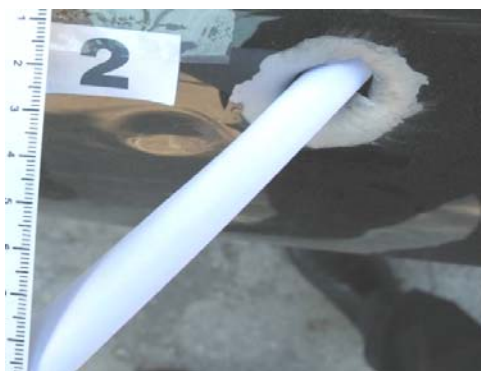
Иллюстрации 10–11. Повреждения № 1 и № 2, завизированные с помощью зонда
