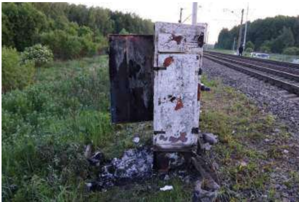
Рис. 3. Внешний вид сгоревшего релейного шкафа
