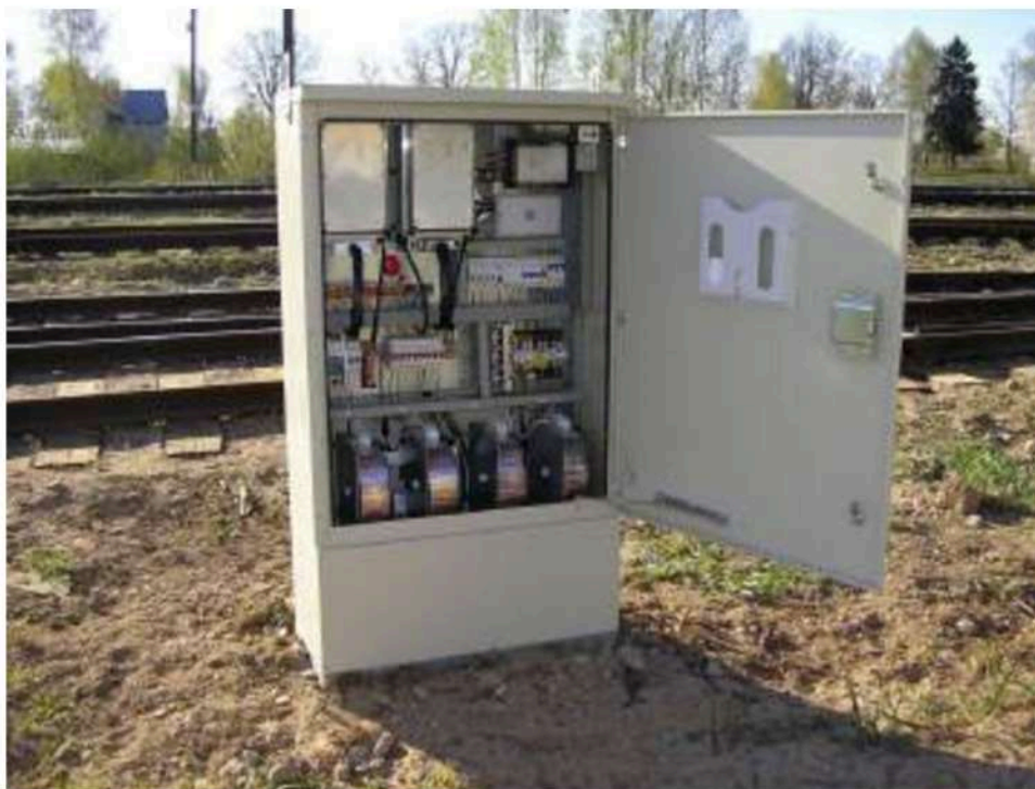
Рис. 2. Наполнение релейного шкафа
