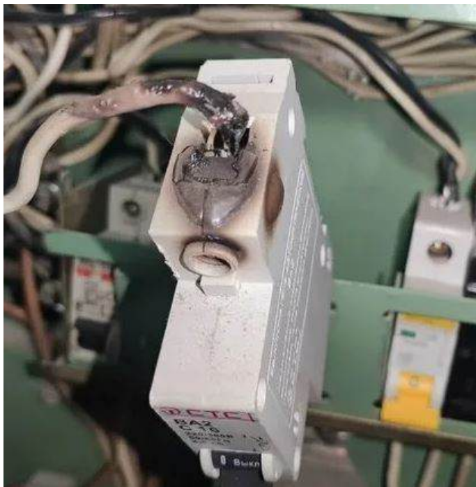
Рис. 16. Наличие оплавления контактного соединения на корпусе устройства защитного отключения – автомате в электрическом щите
