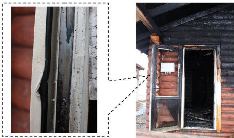
Рис. 7. Следы орудия взлома на входной двери нежилого помещения (общественной муниципальной бани), где произошел поджог
