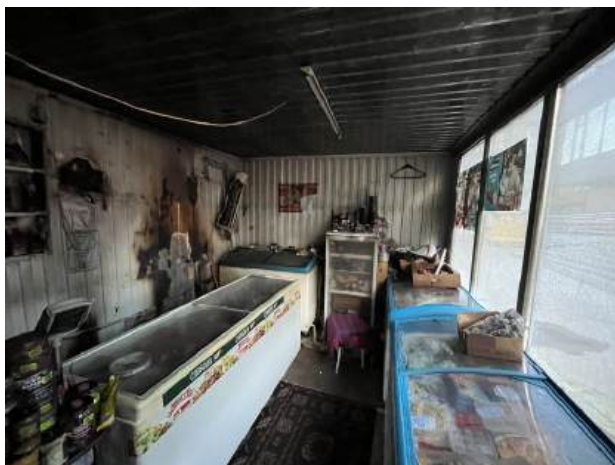
Рис. 13. Расположение холодильников и иного оборудования в торговом павильоне после пожара
