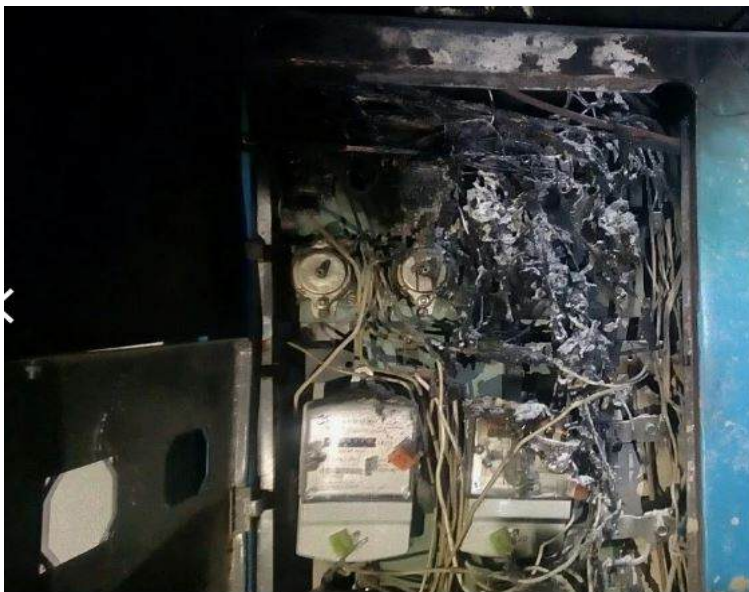
Рис. 14. Состояние выгоревшего электрического щита
