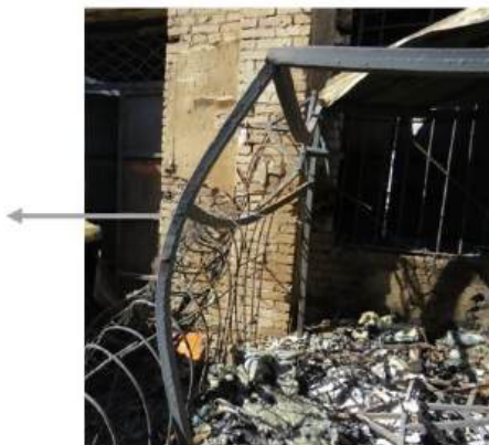
Рис. 11. Металлическая стойка стеллажа деформирована в сторону воздействия огня (стрелкой серого цвета указано направление деформации)
