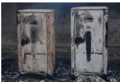
Рис. 33. Следы поджога релейных шкафов
